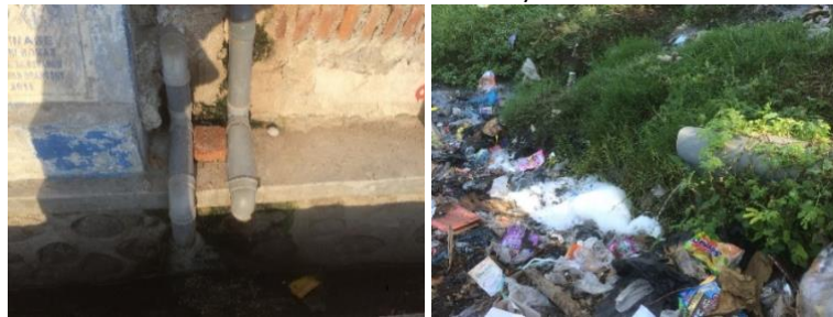
Gambar 2 Limbah yang Langsung Masuk ke Sungai dan Menimbulkan Penurunan Kualitas Air Sungai Brangbiji
