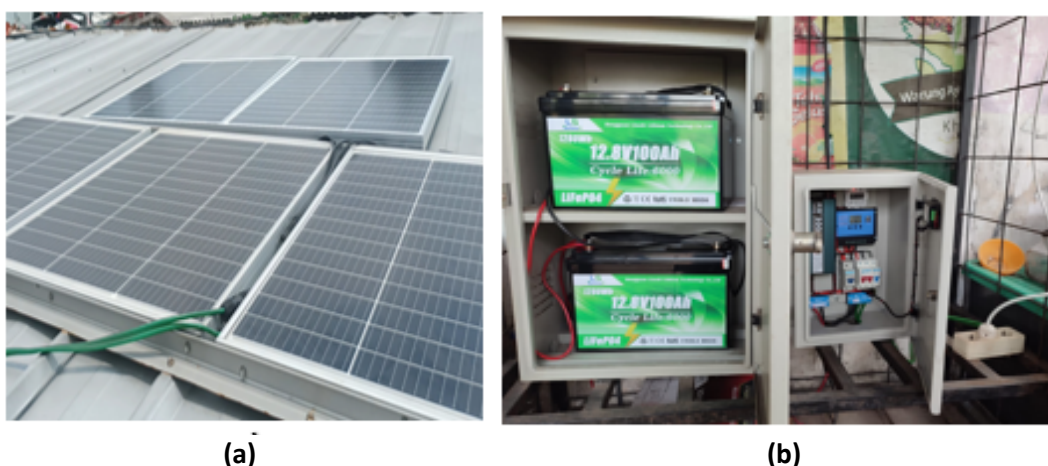
Gambar 3: a). Susunan Panel Surya b). Baterai dan Panel Kontrol
