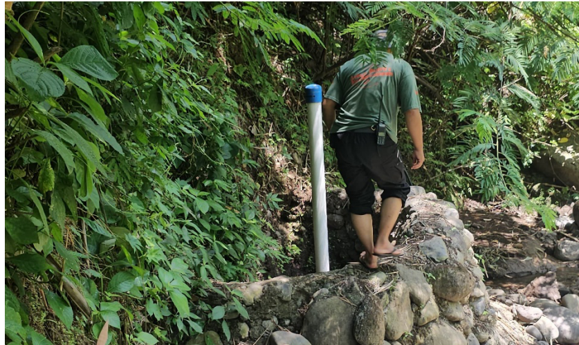
Gambar 8. Pompa Hydran yang Telah Terpasang dan Berfungsi
