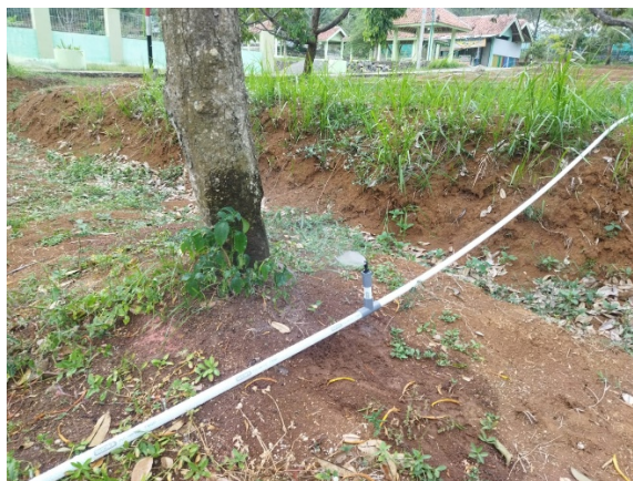
Gambar 5. Instalasi mikro sprayer pada tiap pohon Durian
