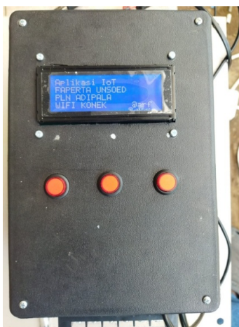
Gambar 2. Pusat Kontrol IoT Fertigasi
