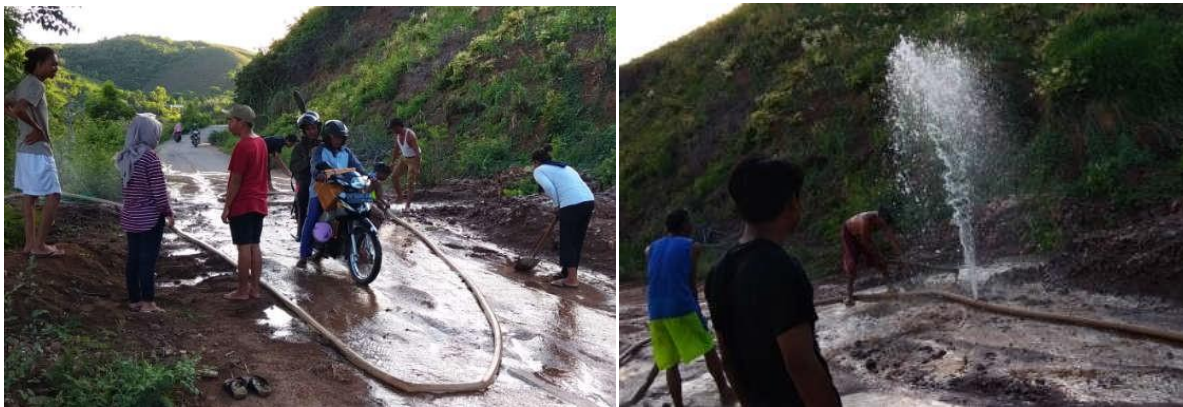
Gambar 3. Pemasangan pipa tipis tapi bocor perlu yang lebih permanen
