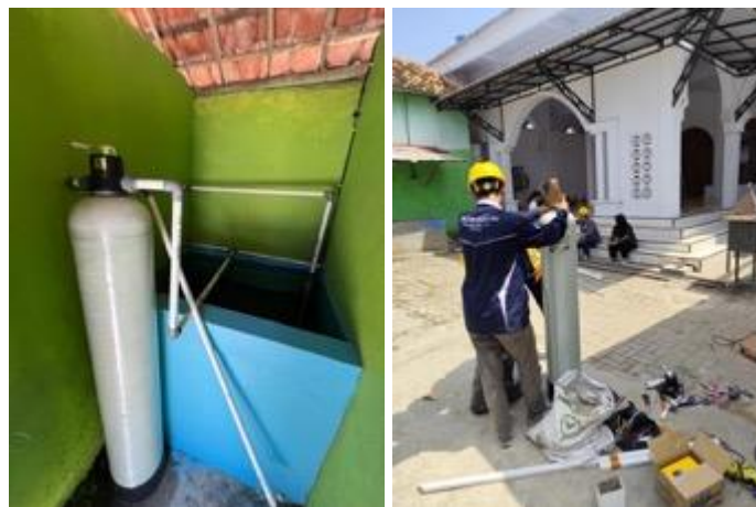
Gambar 8. Unit filtrasi air berbasis pasir dan karbon aktif yang dipasang.
