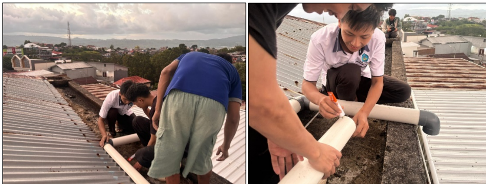
Gambar 2. Instalasi Pemanenan Air Hujan di Atap Sekolah
