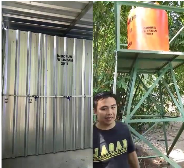
Gambar 2. Set Fasilitas sanitasi 1 – pelataran cuci dan tandon penampung air
