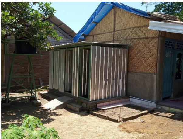
Gambar 3. Set fasilitas sanitasi 2
