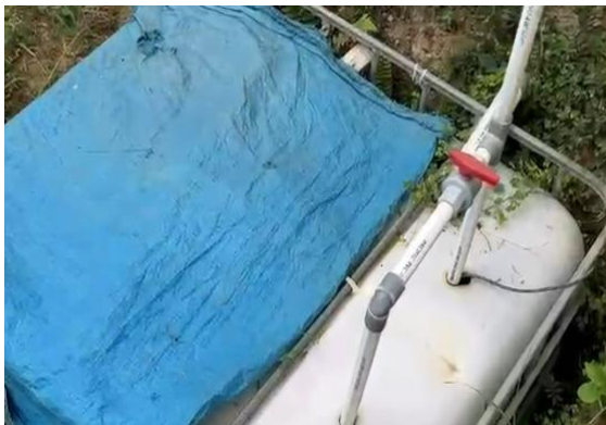
a. Tangki air dan tempat pompa
